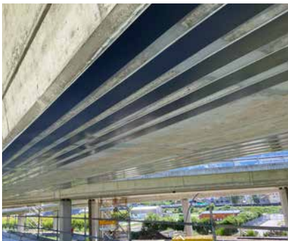
Biegeverstärkung mit oberflächlich, schräg geklebten S&P C-Laminaten
