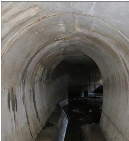
▲ Ist-Zustand des Kanals
