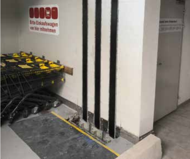
▲ Die Spezialverankerungen aus Stahl leiten die Kräfte in die Betonkonstruktion ab.
