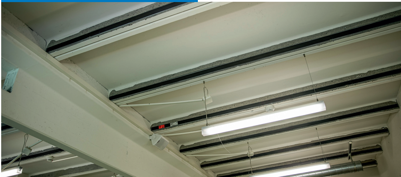
▲ Au total, 2,1 km de S&P C-Laminate renforcent la dalle de la piscine. Image: S&P
