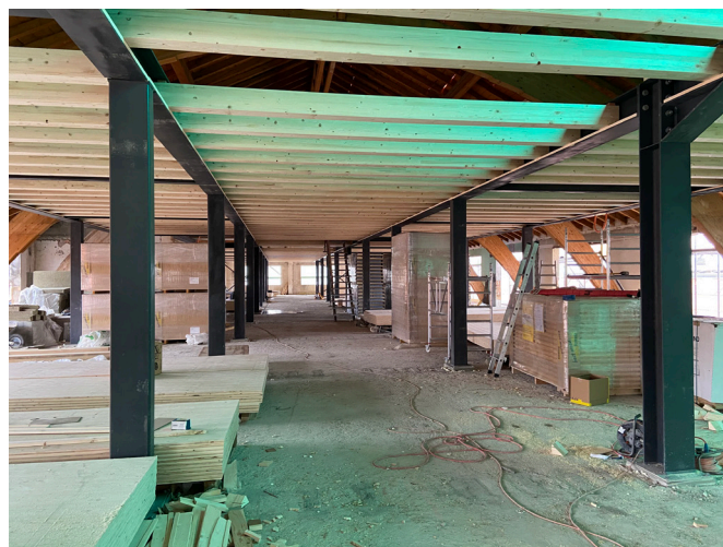
▲ Aperçu de la nouvelle construction de mezzanine sur le dernier étage engendrant des charges supplémentaires sur les poutres inférieures.
