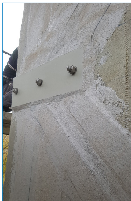
▲ Pose des plaques de recouvrement des lamelles collées à la S&P Resin 220. Sable de quartz pour garantir l'adhérence du futur revêtement.
